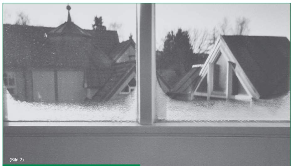
(Bild 2) Tauwasser an der raumseitigen Glaskante, häufig ein Grund für Ärger
